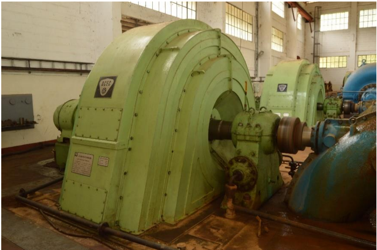
Figure 2 - En vert, les deux alternateurs de Budana
